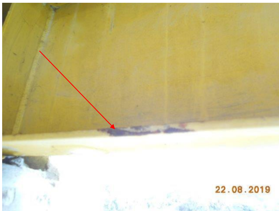
Foto 66 Oxidação superficial no perfil longitudinal lado Oeste, face Leste do vão 2.
