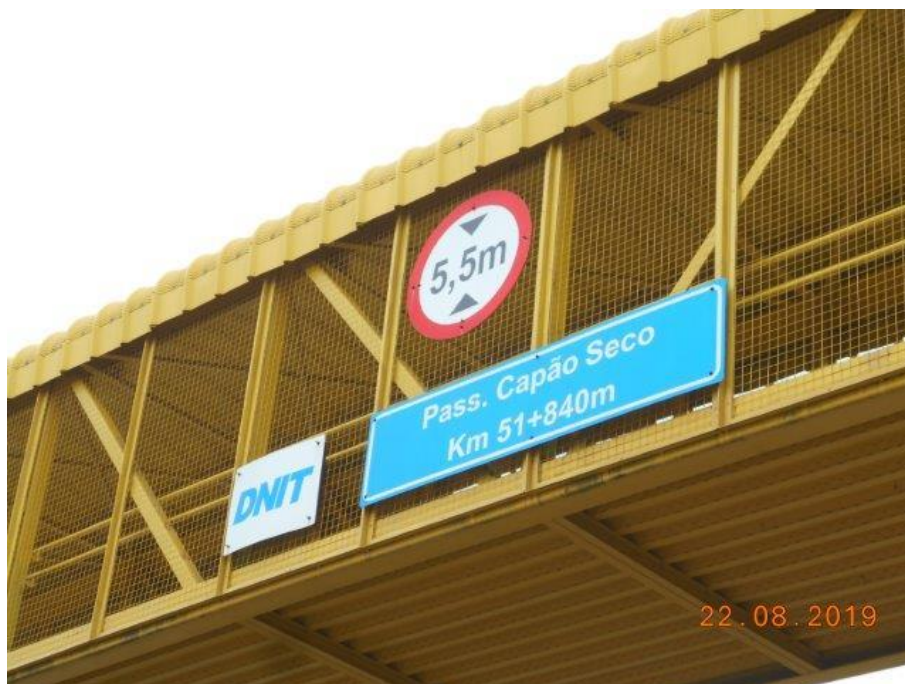
Foto 06 Idem foto anterior – Vista em detalhe para placa de sinalização de gabarito vertical na pista marginal Norte.
