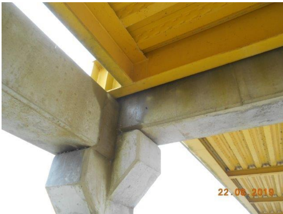
Foto 80 Mancha de umidade na viga travessa TR14, face Oeste e TR17, face Norte.
