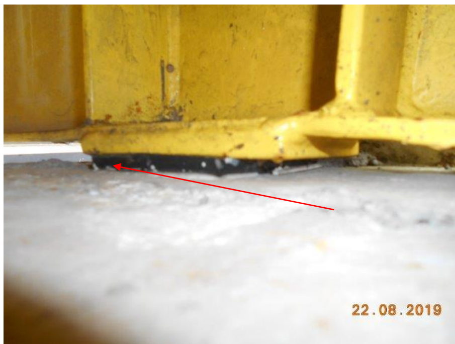
Foto 14 Vista do aparelho de apoio AA4 com leve deformação longitudinal.
