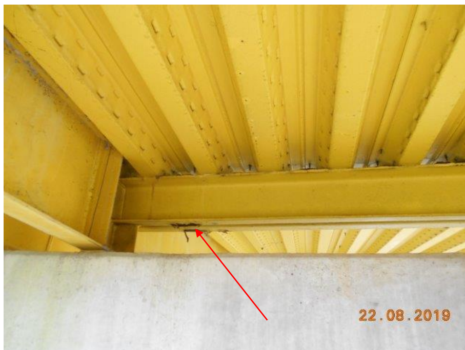
Foto 64 Oxidação superficial no perfil transversal, face Sul do patamar 1.
