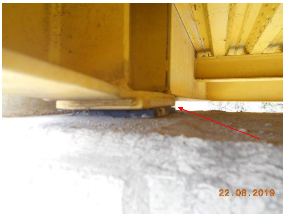
Foto 18 Vista do aparelho de apoio AA14 com deformação e deficiência de contato.
